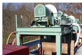
5. 沈殿した汚泥は脱水機へ →再利用土として搬出
