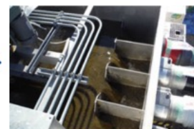
3. 凝集させ沈殿槽へ 【90m濁水処理機】
